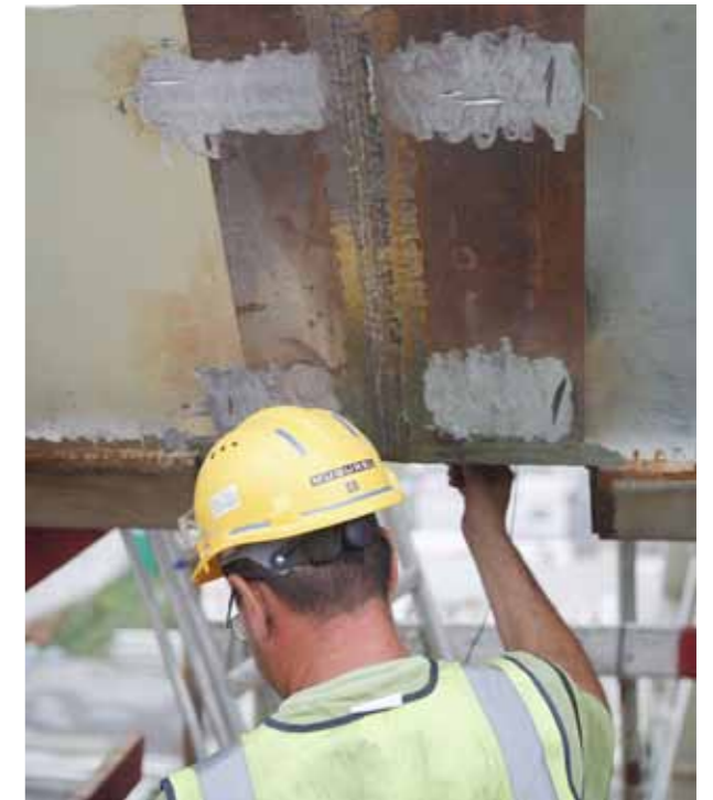
Every completed welding seam is checked by a technician for its electrical conductivity, in order to identify welding failures at an early stage. Ein Schweißingenieur prüft anhand des elektronischen Widerstands die Güte der Schweißnaht und gibt diese im positiven Fall frei.
