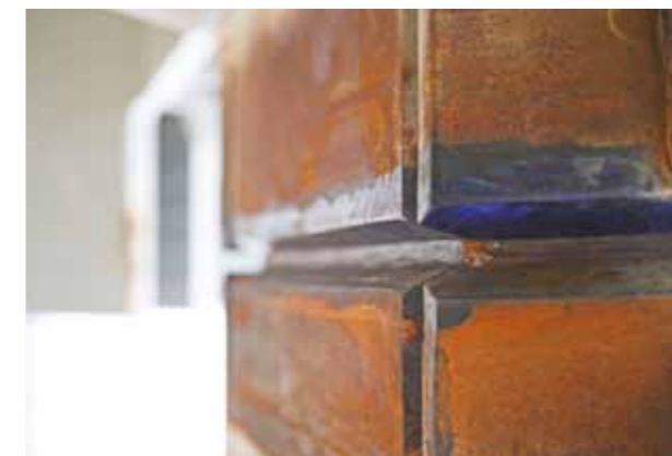
An open welding seam of the steel construction has an average size of 3 x 3 cm. Eine offene Schweißnaht der Stahlkonstruktion misst im Schnitt rund 3 x 3 cm.
