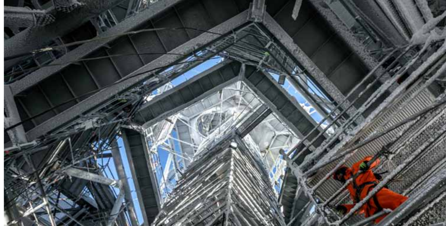
Like a five-pointed star: The plan of the 13-metre-high spire corresponds back to the plan of the ground floor. Einem fünfzackigen Stern ähnlich: Der Grundriss der 13 Meter hohen Turmspitze gleicht wieder dem Grundriss des Erdgeschosses.
