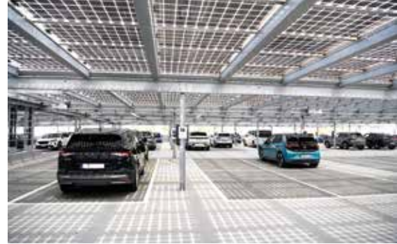
Ein Parkhaus im niederbayerischen Vilsbiburg mit 7.000 m 2 Indach-PV.
